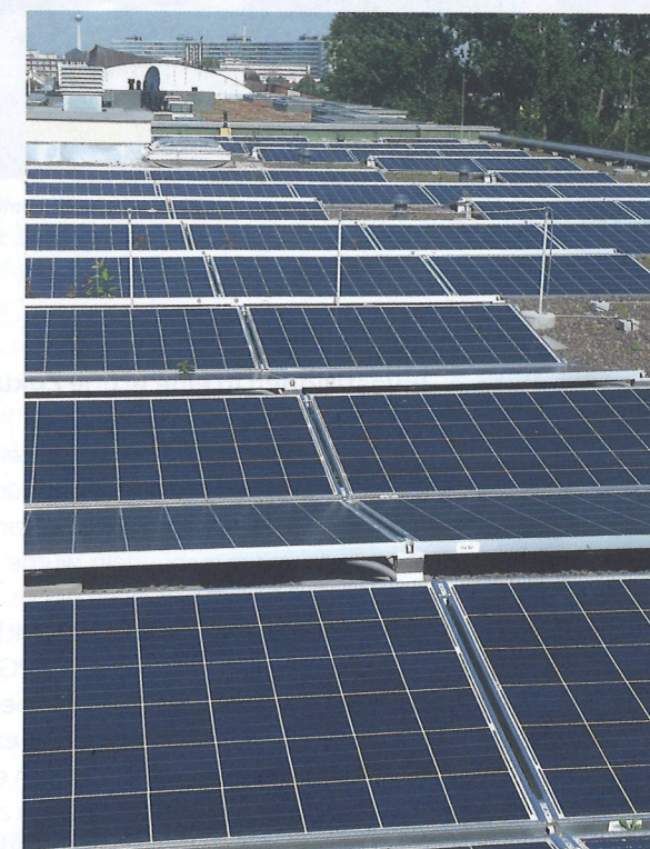
Über die Fotovoltaikanlage auf dem Dach beziehen die Mieter in der Berliner Giselastraße ökologischen Strom.
